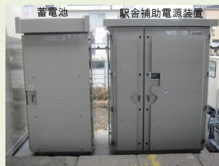
蓄電池付駅舎補助電源装置
